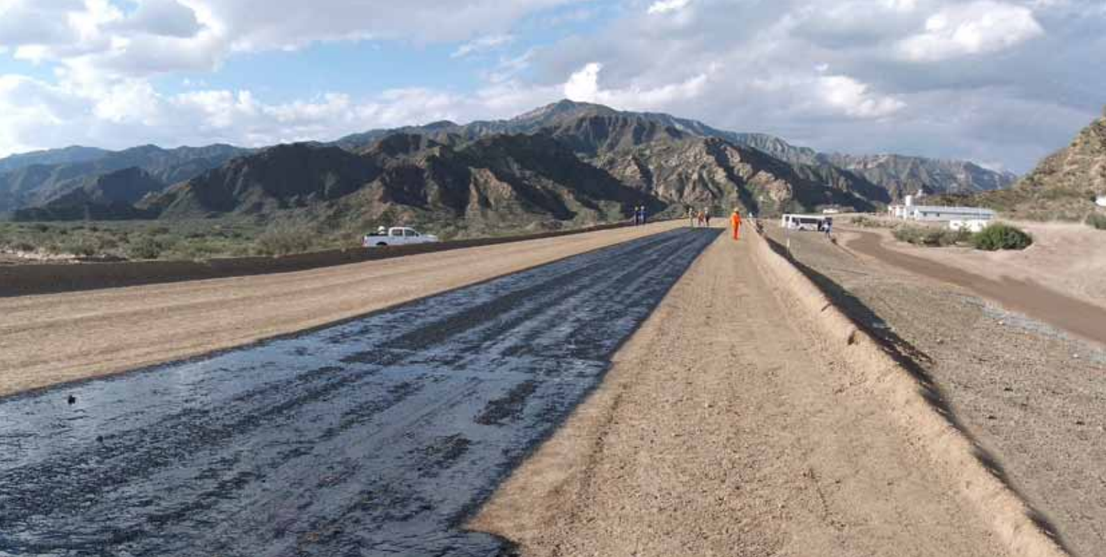
El camino solitario: En este desierto argentino, a 300 km de la ciudad más cercana, JCCC trabaja con un contrato "llave en mano" para entregar 24 km de camino completo con seis túneles y cinco puentes.
