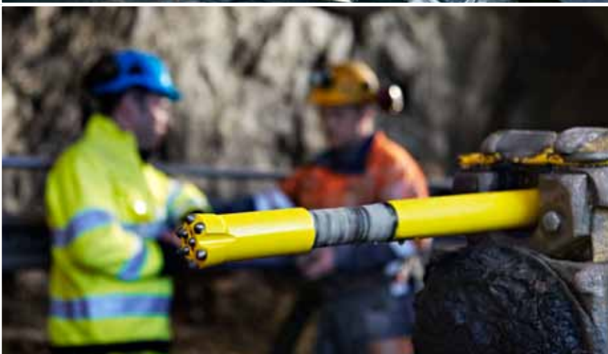
来自阿特拉斯·科普柯赛柯洛克的优质钻具帮助承包商 Oden 公司在斯德哥尔摩城市地铁线路工程中恢复到原有的进度。
