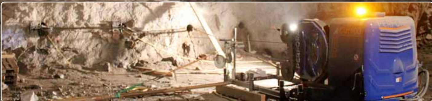
Соблюдая тишину в Стокгольме: станок SpeedCut, не создавая вибрации, выпиливает гранит, освобождая пространство для нового подземного тоннеля.
