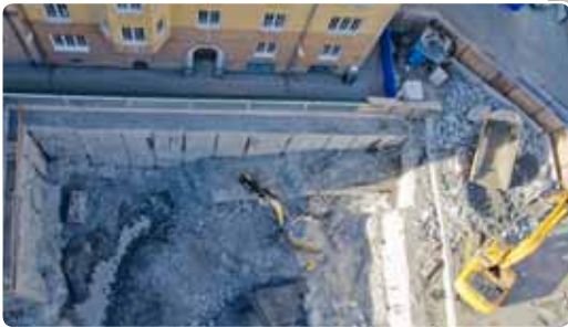
Вибрация под контролем: защита близстоящие жилые дома и церковь Св. Матфея (справа). Объекты – в 1-м м над рабочей площадкой.
