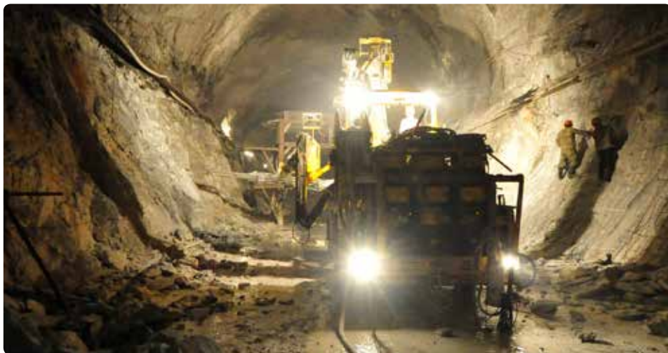
雅礮江(がろうこう)屈曲部の現場にて:Jinping II水力発電所プロジェクトの導水路トンネル内を走行するアトラスコプコBoomer 353 E。プロジェクト マネジャーのクアン・リーさんはBoomerを「まるでこのプロジェクト用に作られたようだ」と言います。
