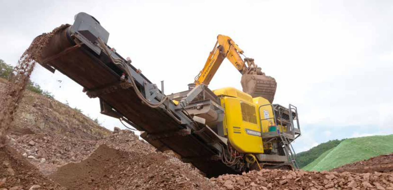
环保型采石作业：Wonjin Construction 公司利用 Powercrusher PC 4 型破碎机为韩国的基础设施扩建提供混凝土原料，这张照片拍摄于在建的30号公路附近的 Andong 采石场。
