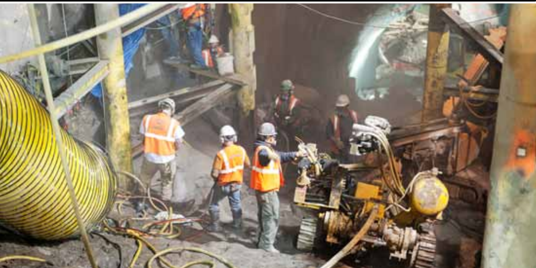
Un gran desafío: Trabajadores montando el FlexiROC T30 en la chimenea de acceso en el extremo norte del proyecto de la calle 86.
