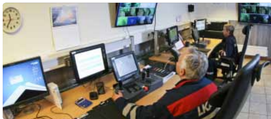
На безопасном расстоянии: комната управления на Мальмбергете, где каждый оператор отвечает за два станка Simba. Здесь начальник производства Бенгт Анттила проверяет журналы регистрации с ночной смены.
