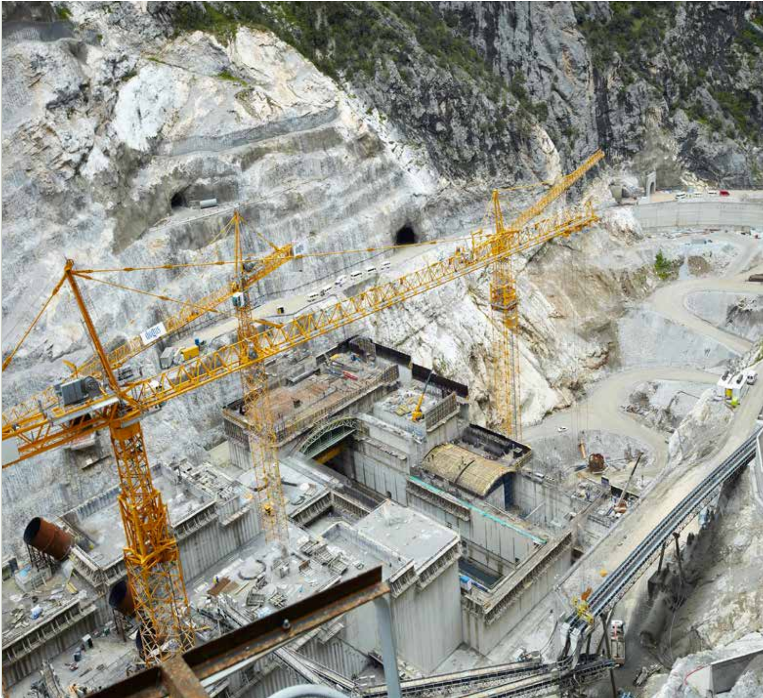
グラウティングの難関・トルコのボヤバトダムは岩盤補強と安定化プロジェクトは前代未聞の水力発電建設の一環でした。
