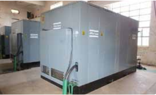
La potencia: Algunos de los compresores GA especialmente diseñados, en la superficie.
