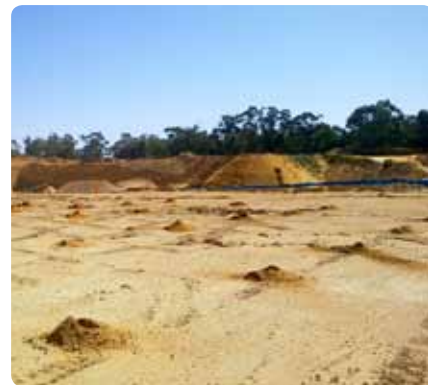
¡Trabajo terminado! El diagrama de 15 pozos, tres hileras de cinco por hileras, después de la perforación totalmente automatizada.
