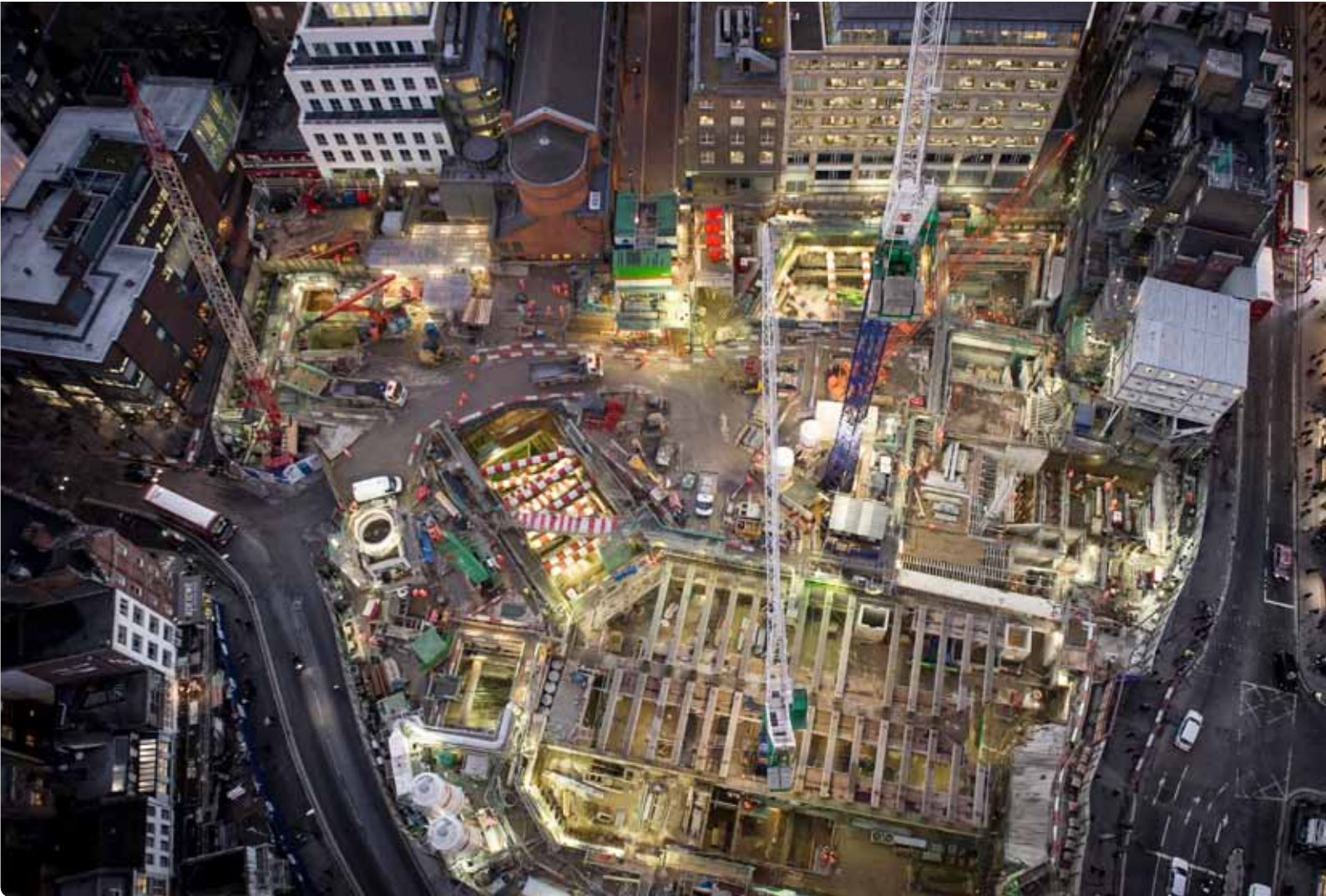
Vista aérea de la obra: La estación Tottenham Court Road es solo una parte del gigantesco proyecto Crossrail para modernizar todo el Metro de Londres. Con unas 10.000 personas trabajando en 40 obras, será el mayor proyecto de construcción en Europa.
