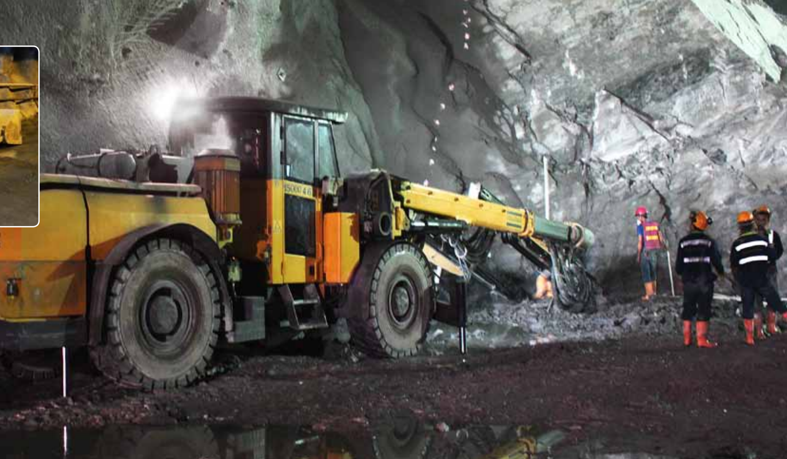
Abriendo camino a más energía: Un equipo de perforación Boomer E2 C de dos brazos, de la flota de Atlas Copco, excavando los túneles y las cavernas en Ituango, que aumentarán la capacidad energética de Colombia en 2.400 MW más.
