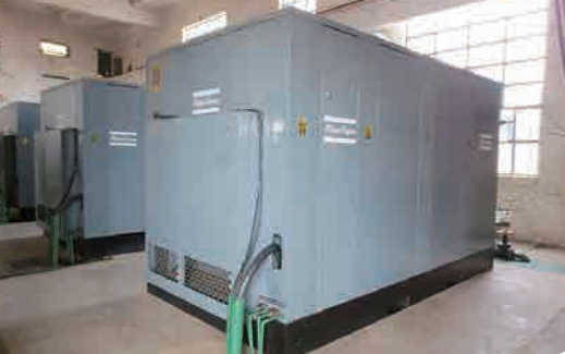
供給源:特別仕様のGAコンプレッサーが設置され、圧縮空気を供給しています。
