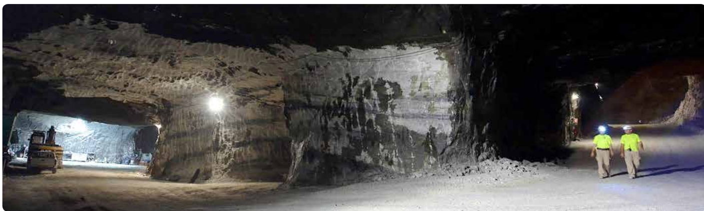
強さと信頼性:スペインのバルセロナにあるXauxa大理石鉱山では、アトラスコプコ社製のSwellex Spartanのロックボルトを使用し、新しい岩盤補強のプログラムを実施しています
