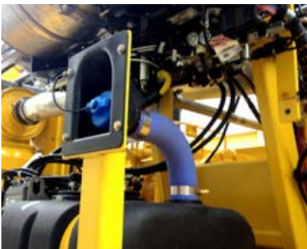
在Pit Viper钻机上安装的易于识别的蓝色加注盖和软管。
