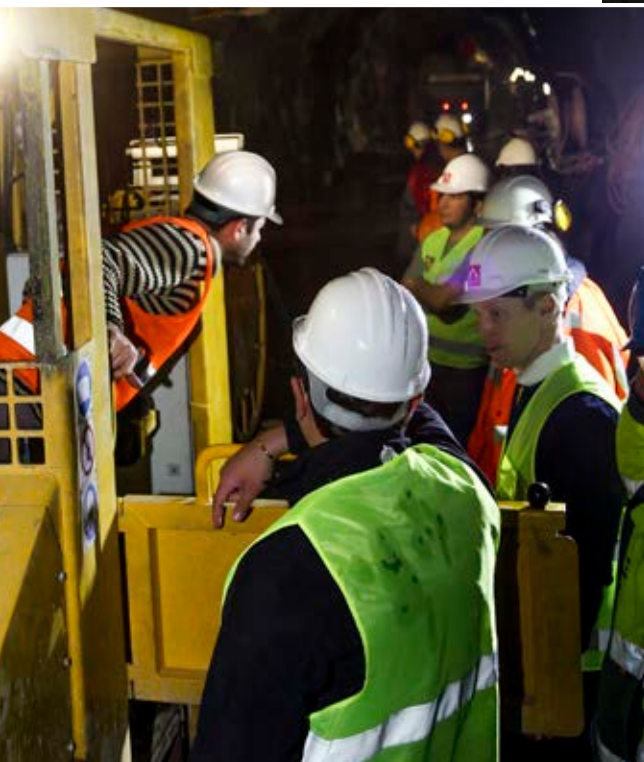
在隧洞内：上图，施工团队正在讨论如何在工作面的狭窄空间内优化设备的布置。
