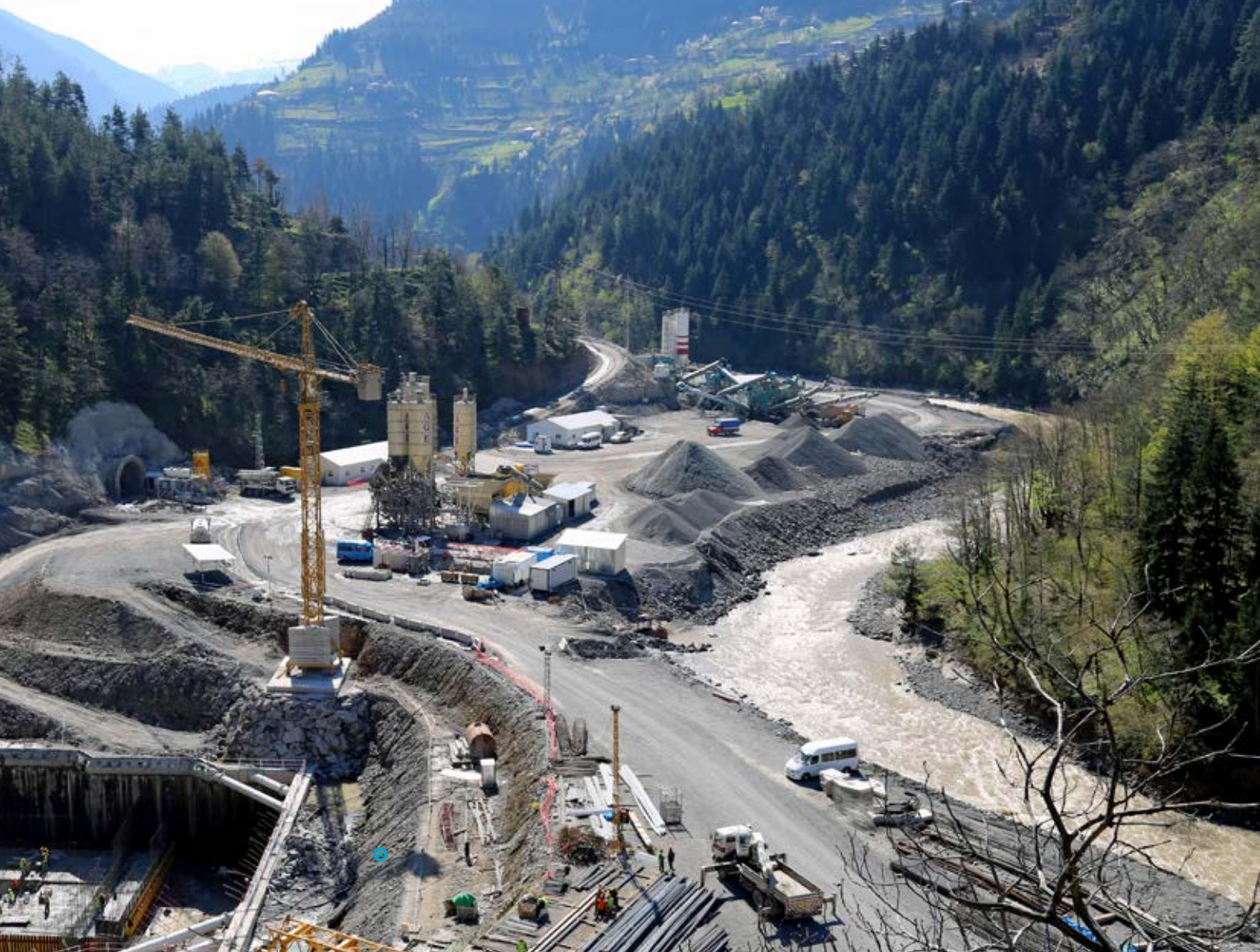
项目工地全景图：从照片上可以看到引水隧洞（上中）和主厂房地基。
