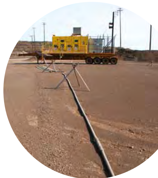
El costo de mover: Mover un cable eléctrico a un nuevo diagrama puede llevar horas y mover un equipo como mínimo un día.
