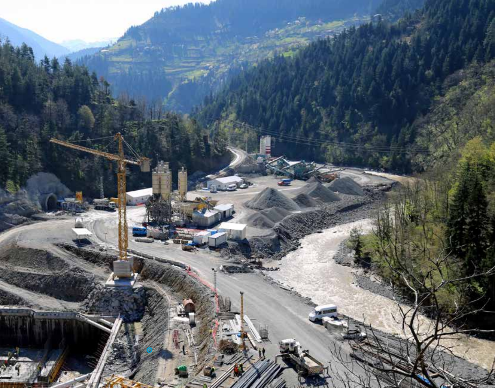
プロジェクト現場の概観：取水トンネル(写真中央上)と主要プラント設備の基礎部分
